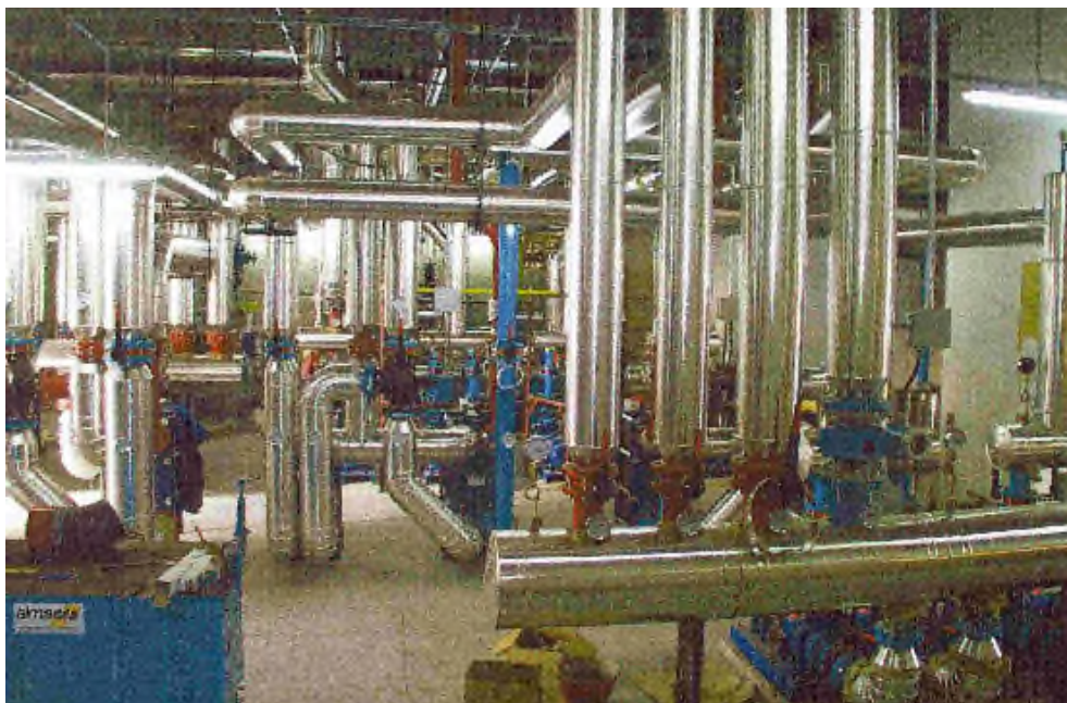
IMPIANTO DI COGENERAZIONE MERKER - POTENZA ELETTRICA 2X3.500Kwe - POTENZA TERMICA 2X3.3860Kwt
